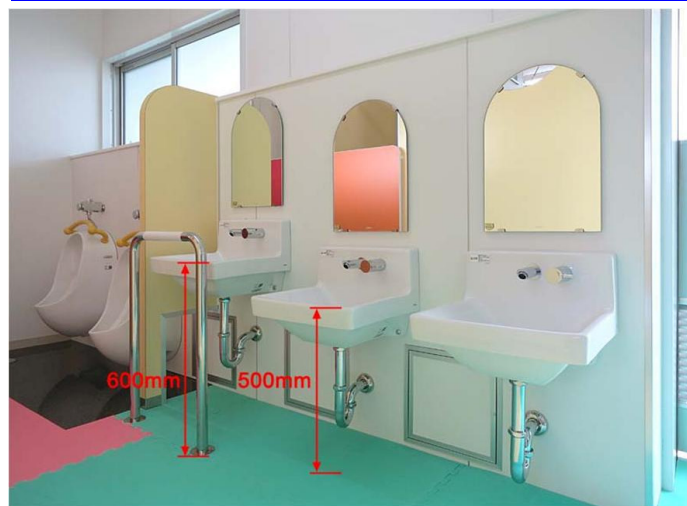
肢体に障がいのある園児が、後ろから身体を支えてもらいながら手洗いできるように洗面器の前に手すりを設置。洗面器は園児たちが使いやすい高さを選べるように、500mm・600mmの高さ違いで設置。
