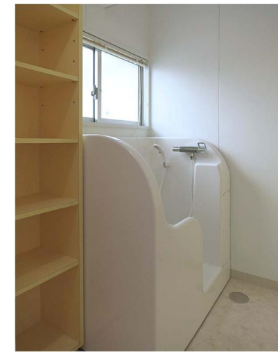
粗相をしてしまった場合などに備えて、幼児用シャワーパンを設置している。
