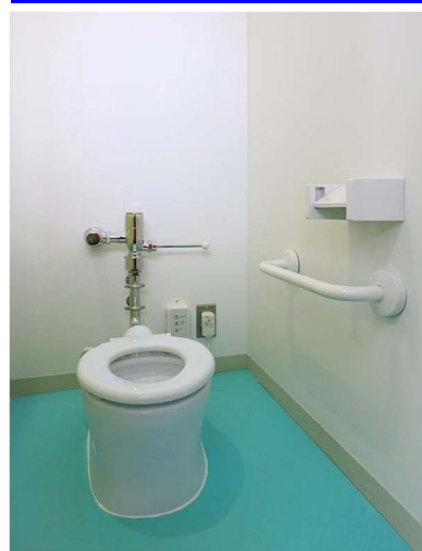
3-5歳児向けの幼児用大便器を設置した大便器ブース。冬場も快適に使えるように暖房便座を設置している。
